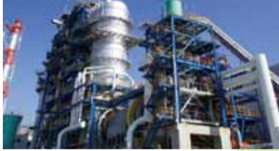
廃棄物中間処理施設
